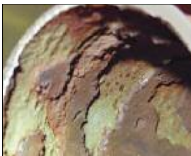
Korrosion in Form von Rost und Ablagerungen
